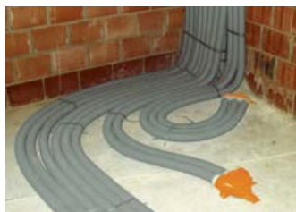
Instalacja R-VENT Flex prowadzona pod stropem drewnianym (docelowo w warstwie izolacji).
