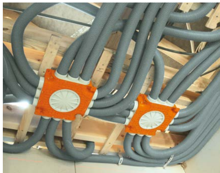
Instalacja R-VENT Flex prowadzona pod stropem drewnianym (docelowo ukryta w warstwie izolacji).
